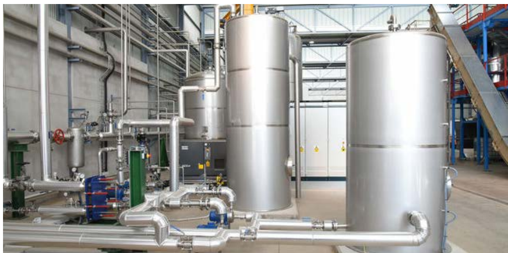
La planta de Clamber en Puertollano
