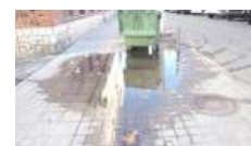
Reposiciones mal ejecutadas
