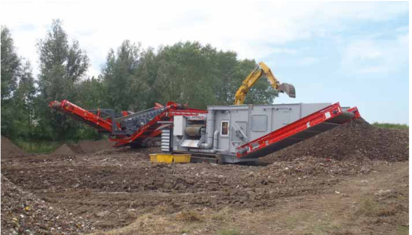
FIGUUR 2: "NIR IN THE BOX" MOBIELE OPSTELLING VOOR ON-SITE INNOVATIEVE MATERIAALSORTERING.
