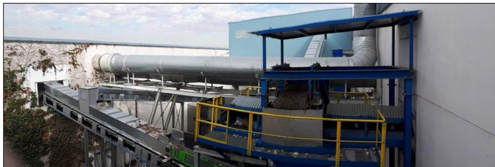
Figură 3 Centrul regional de gestionare a deșeurilor Ecoparque de Toledo, Spania
